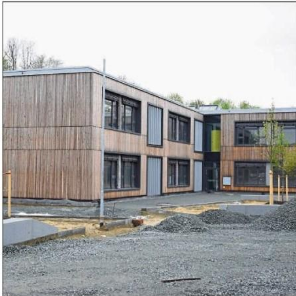
Der Schulneubau kommt gut voran: Endlich konnte mit den Arbeiten an der Außenanlage begonnen werden.
