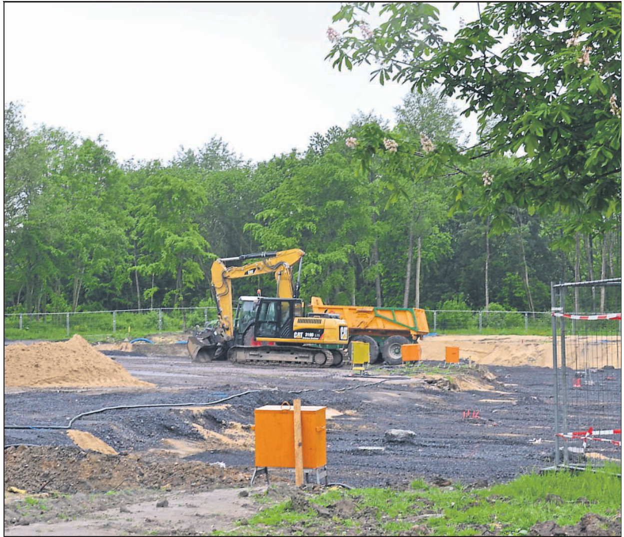
Gestern Mittag: Auf der Baustelle hinter dem Bildungszentrum wird zurzeit nicht gearbeitet, weil immer wieder Grundwasser in die Baugrube sickert. Foto: Reh
